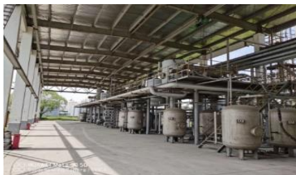
木质纤维制备乙酰丙酸及酯生产线
